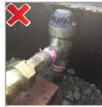
PRV in box
