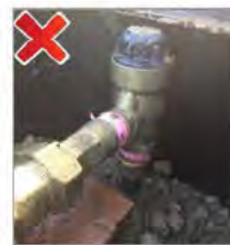
PRV in box
